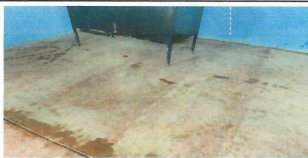
Foto 4: Sustrucción de piso cerámico
