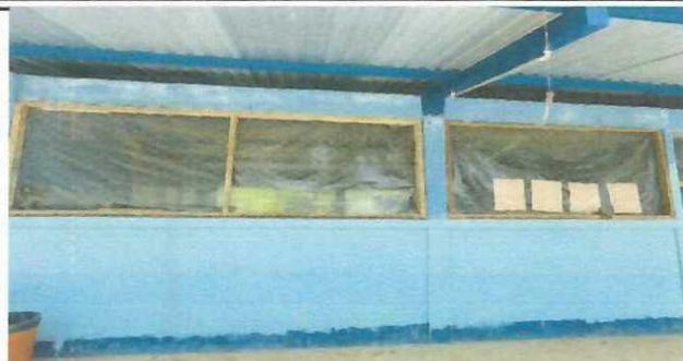
Foto1: Sustrucción de ventanas de madera por metal mas vidrio (parte frontal) dificultad para ventilación en aulas.
